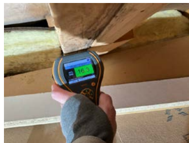
Fuktmerker i deler av undertaket.
