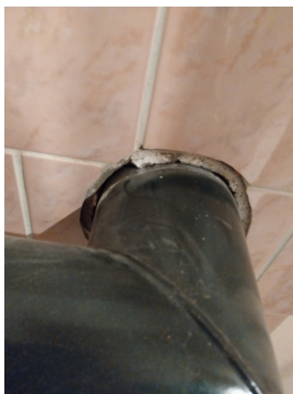
Det er usikkerhet knyttet til tettheten rundt røykinnføringen i pipen på bad/vaskerom i kjeller.
