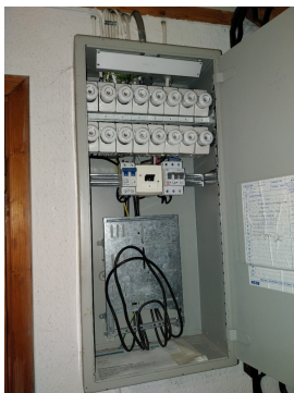
Stigerskap er plassert i kjeller, i entré/gang.
