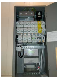
Hovedsikringskap i trappeløp mellom kjeller og 1.etasje.
