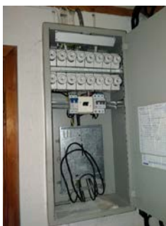
Stigerskap er plassert i kjeller, i entré/gang.
