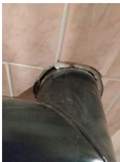
Det er usikkerhet knyttet til tettheten rundt røykinnføringen i pipen på bad/vaskerom i kjeller.
