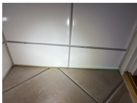
Riss i fuger og sprekke i flis.
