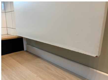
Svelleskader i bunn av dør.
