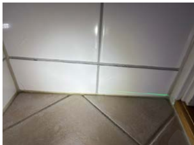
Riss i fuger og sprekk i flis.
