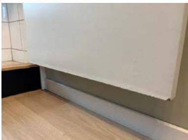
Svelleskader i bunn av dør.
