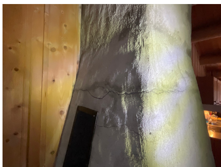
Sprekker i peiskappe
