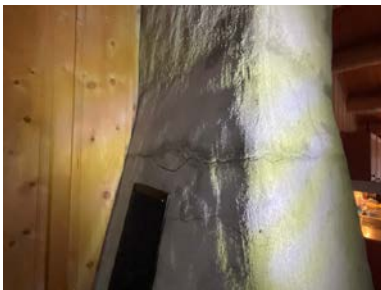
Sprekker i peiskappe
