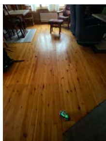
Ca 13cm høydeforskjell i stue fra laserpunkt til hjørne i sør.
