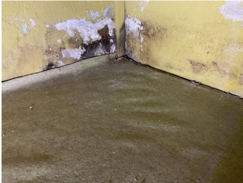
Fukt på mur i matbod.
