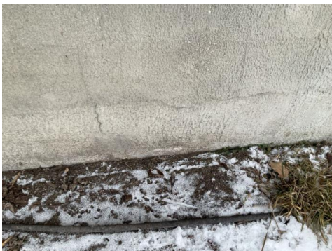
Riss i grunnmur.
