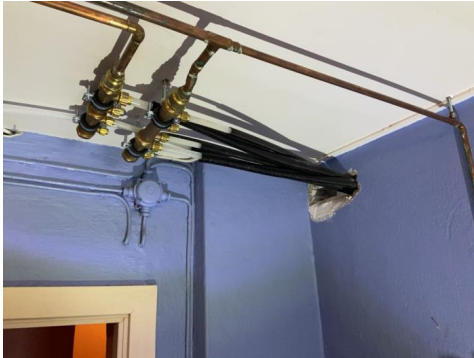
Vannrør fra bad og vaskerom.
