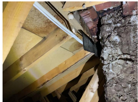
Noe fuktmerker ved gjennomgang til pipe på gammel del.
