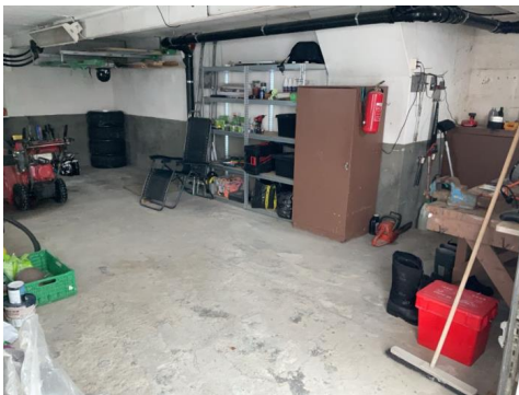
Utett brannskille ved avløpsrør.
