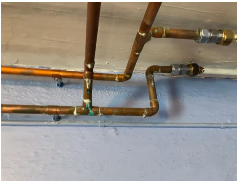
Noe irr på gamle vannrør.
