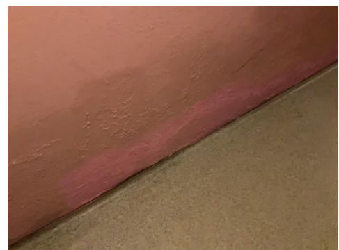
Fuktsvelling i betongmur i gang.
