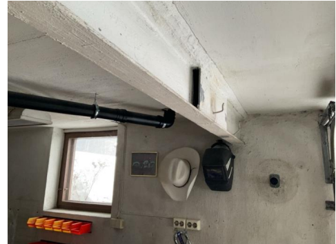
Bærende stålbjelke i garasje er ikke brannsikret.
