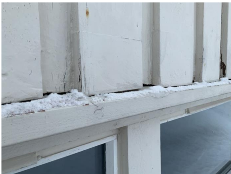
Mulig råte over vinduer mot øst i tilbygg.
