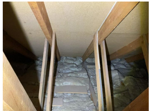
Manglende lufting ned mot yttervegg.
