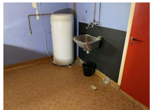
Vaskerom med utett belegg på gulv.
