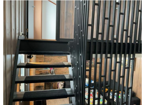
Stor åpning mellom trinn.
