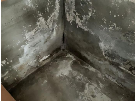
Fukt på yttervegg i garasje.
