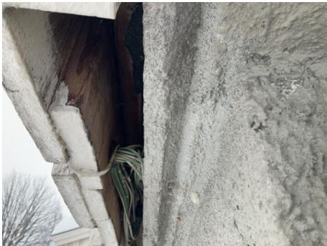
Lite lufting i nedre kant av kledning.
