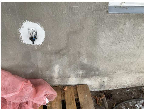
Setningsriss i grunnmur.
