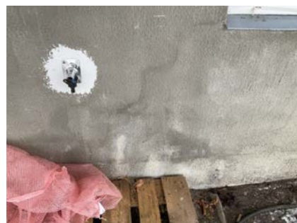
Setningsriss i grunnmur.
