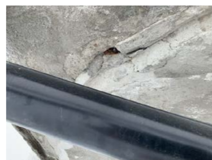
Rust på armeringsjern på støpt veranda.
