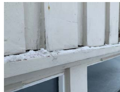
Mulig råte over vinduer mot øst i tilbygg.
