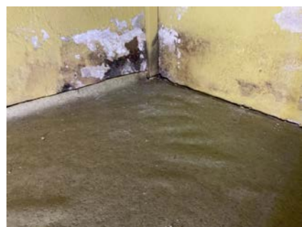
Fukt på mur i matbod.
