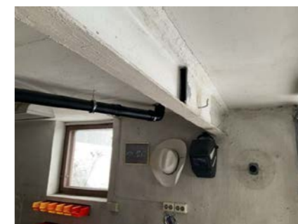
Bærende stålbjelke i garasje er ikke brannsikre.
