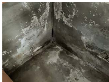
Fukt på yttervegg i garasje.
