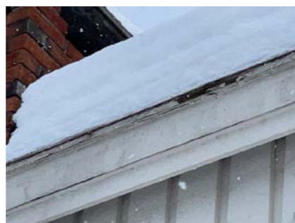
Mulig råte i dekkbord på tilbygg.
