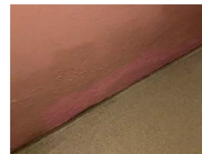
Fuktsvelling i betongmur i gang.
