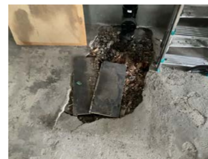
Hull i betonggulv.
