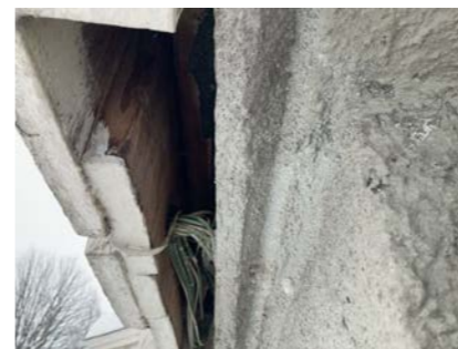
Lite lufting i nedre kant av kledning.
