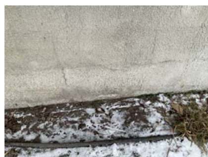
Riss i grunnmur.
