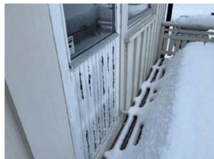
Løs maling på ytterdør.
