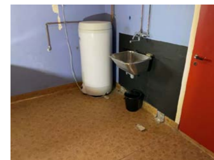
Vaskerom med utett belegg på gulv.
