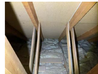
Manglende lufting ned mot yttervegg.
