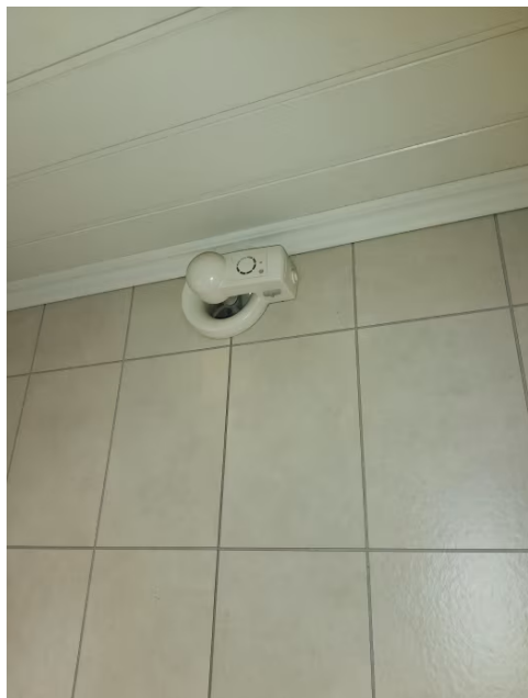
Bilde viser avtrekksvifte.
