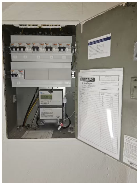
Bilde viser sikringskap.
