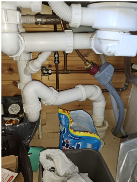
Bilde viser røropplegg under oppvaskkum.
