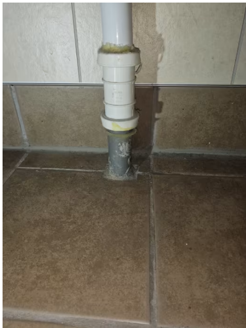
Bilde viser avløpsrør fra servant på bad.
