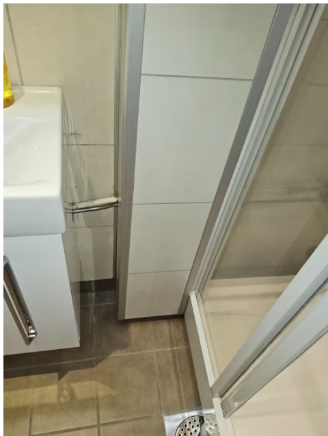
Bilde viser vannrør inn til kasse på bad.
