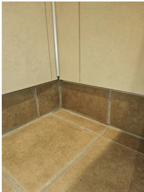
Bilde viser ufagmessig utførelse av baderomsplater.
