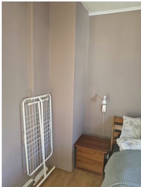
Bilde viser pipe på soverom.
