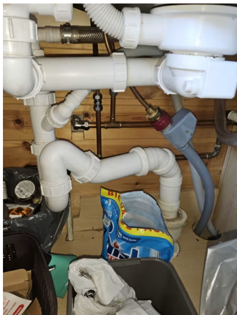
Bilde viser røropplegg under oppvaskkum på kjøkken.
