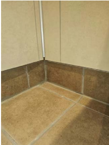
Bilde viser ufagmessig utførelse av baderomsplater.
