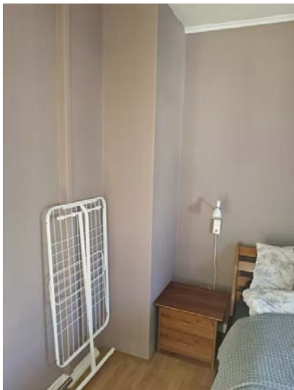
Bilde viser pipe på soverom.
