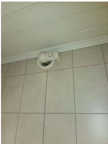
Bilde viser avtrekksvifte.
