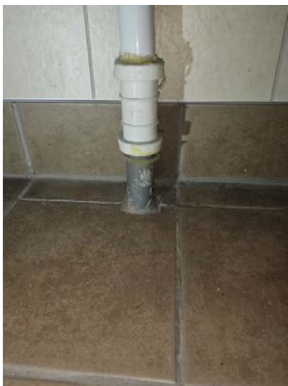
Bilde viser avløpsrør fra servant på bad.
