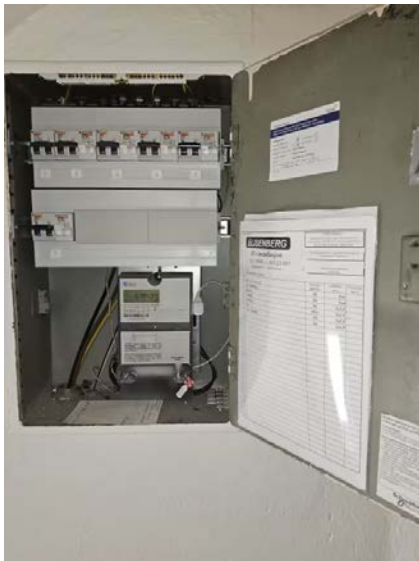
Bilde viser sikringsskap.
