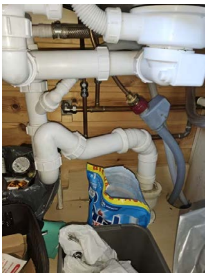
Bilde viser rørøpplagg under oppvaskkum.
