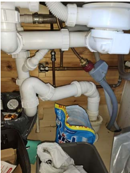
Bilde viser røropplegg under oppvaskkum på kjøkken.
