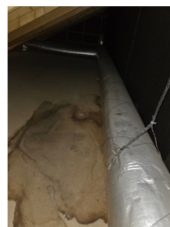
Fuktmerker i gulv som følge av lekkasje fra avløpslufting. Årsak er utbedret og området er tørt under befaringen. Ikke behov for tiltak.
