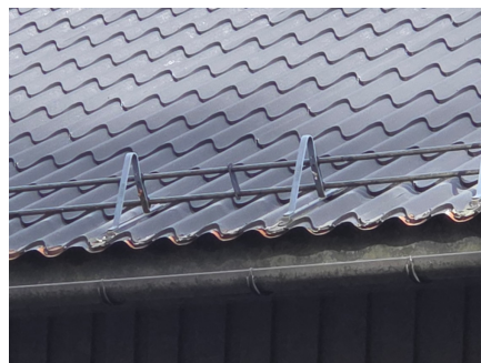
Synlig rust på fremre plateskjøter
