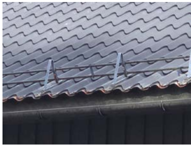
Synlig rust på fremre plateskjøter
