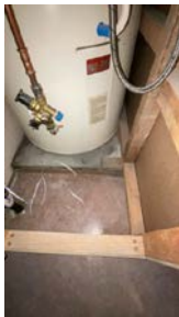
Mangler belegg under varmtvannsbereder. Det er montert vannføler som sikring
