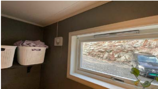
Mekanisk avtrekksvifte på vegg
