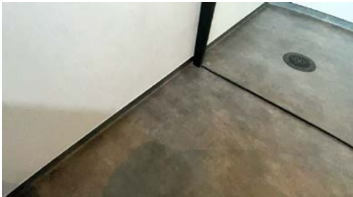
Åpning mellom dusjvegg og vegg for å sikre avrenning til sluk
