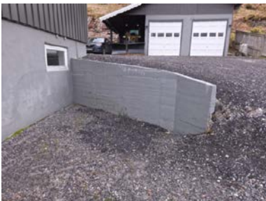
TG 3 er gitt pga. denne muren mangler rekkverk med hardt underlag
