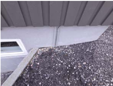
Bildet viser grunnmursplast uten kantlist.
