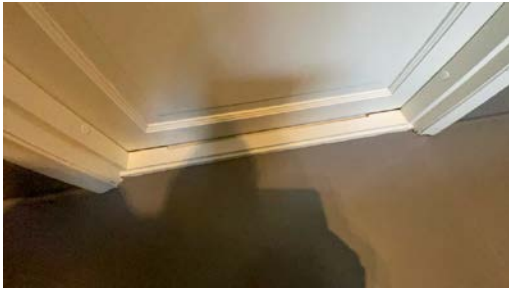
Luftespalte under dør
