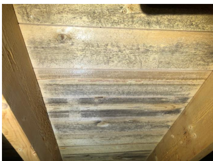
Svertesopp på undersiden av undertak
