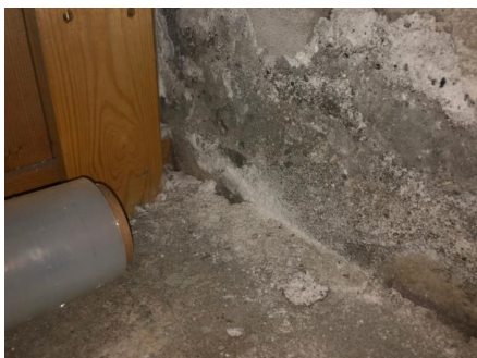
Saltutslag nederst på grunnmur i bod.
