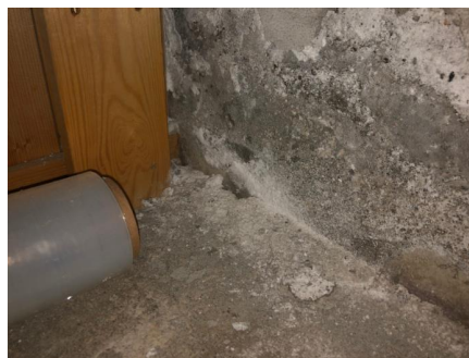
Saltutslag nederst på grunnmur i underetasjen.
