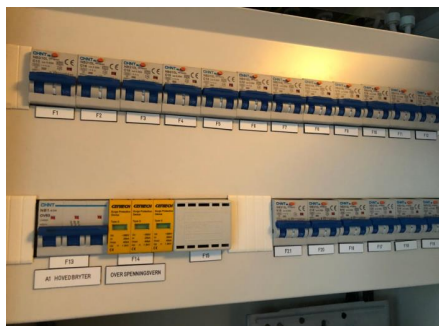
Sikringskapp plassert på kontor underetasjen
