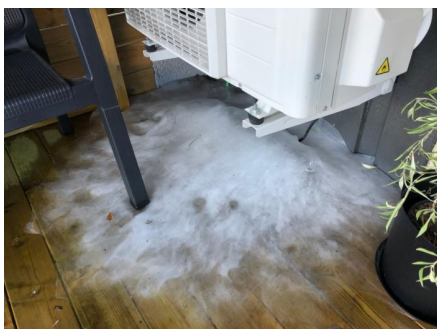
Kondensvann som fryser til is inntil yttervegg i underetasjen
