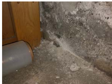
Saltutslag nederst på grunnmur i underetasjen.
