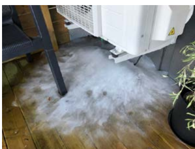
Kondensvann som fryser til is inntil yttervegg i underetasjen
