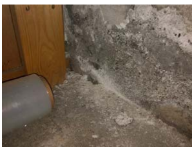
Saltutslag nederst på grunnmur i bod.
