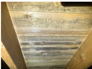
Svertesopp på undersiden av undertak
