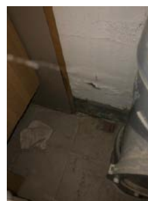
Saltutslag og noe avskalling av maling/puss
