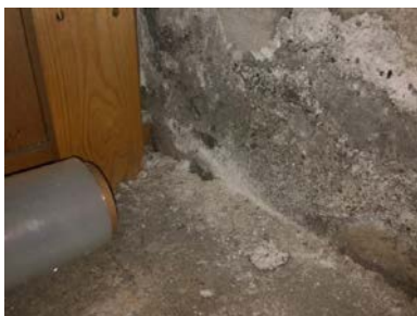
Saltutslag nederst på grunnmur i bod.
