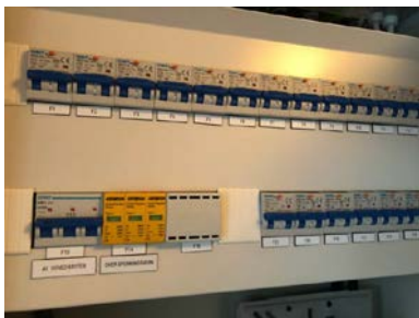
Sikringskapp plassert på kontor underetasjen
