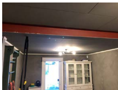
Jernbjelke i kjellerstuen som ikke er innkasset
