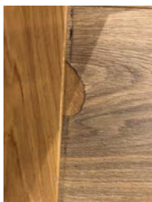
Avskalling av laminat ved dør til stuen.
