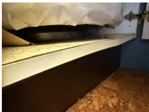
Påbegynt svelling og svipt i benkeskap under varmtvannsbereder.
