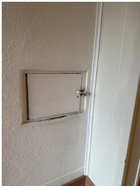
Kort avstand mellom sotluke og brennbart materiale.
