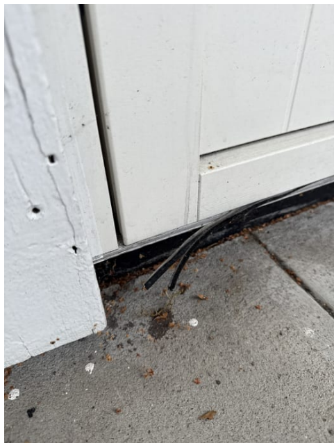
Pakning på balkongdør er løs i bunnen.
