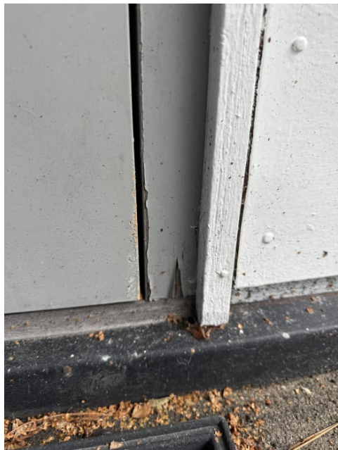
Det registreres stedvis værslitte karmar.
