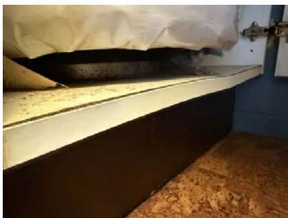
Påbegynt svelling og svikt i benkeskap under varmtvannsbereder.
