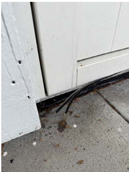
Pakning på balkongdør er løs i bunnen.
