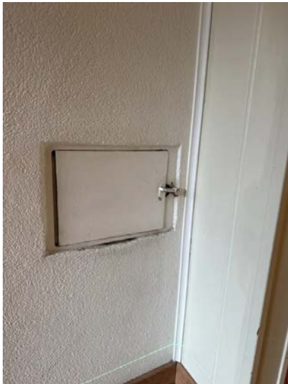
Kort avstand mellom sotluke og brennbart materiale.
