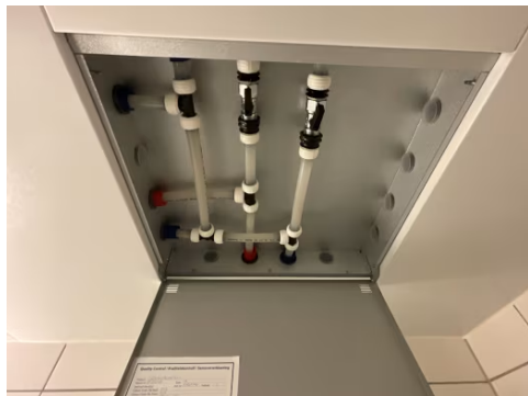
Fordelerskap i himling i bad.
