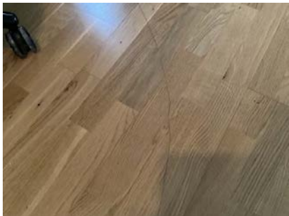
Riss i stue.
