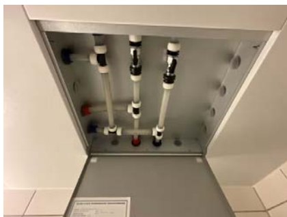
Fordelerskap i himling i bad.
