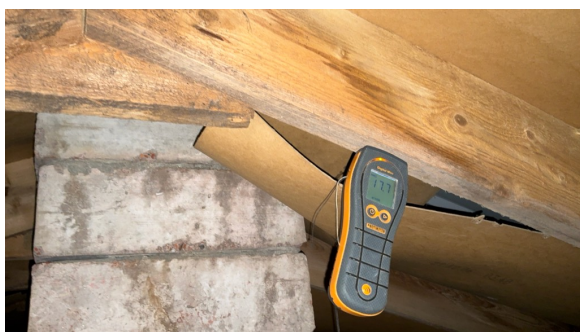
Stedvise fultmerker med utslag på fukt i takkonstruksjon.
