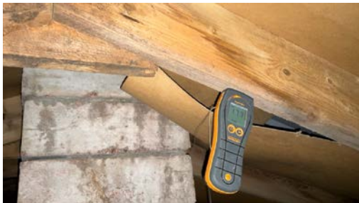
Stedvise fuktmerker med utslag på fukt i takkonstruksjon.
