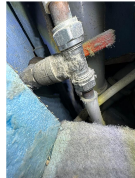
Stoppekran bak luke på toalettrom
