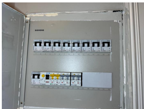
Elskap, plassert i entre/gang (ny kursoversikt)
