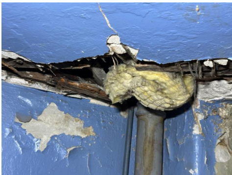
Tørråte i etasjeskiller over baderomshimling
