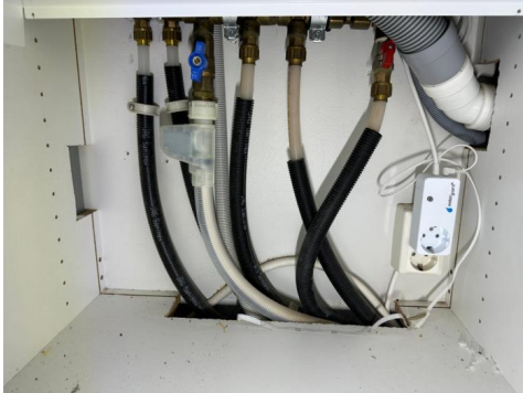
Røropplegg i kjøkkenbenk
