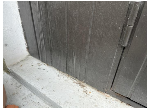
Værslitt utvendig -balkongdør sidefelt
