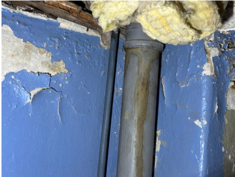
Plast avløpsrør synlig over baderomshimling, 1991
