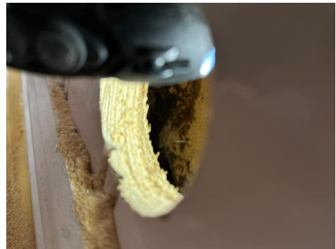
Skader i baderomsvegg
