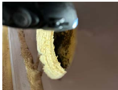
Skader i baderomsvegg
