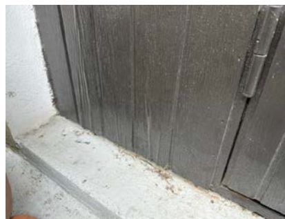
Værslitt utvendig -balkongdør sidefelt
