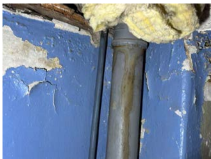
Plast avløpsrør synlig over baderomshimling, 1991
