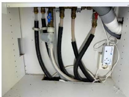
Røropplegg i kjøkkenbenk
