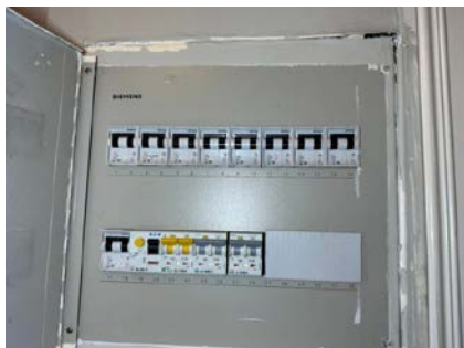
Elskap, plassert i entre/gang (ny kursoversikt)
