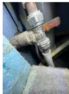
Stoppekran bak luke på toalettrom
