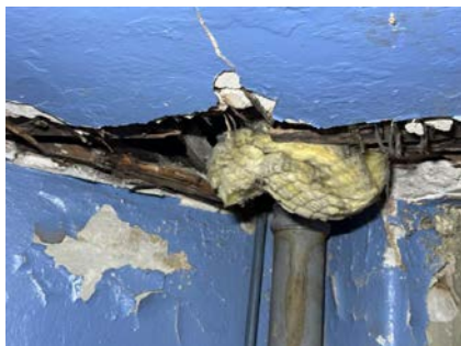
Tørråte i etasjeskiller over baderomshimling
