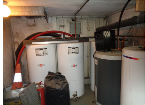
Varmtvannsberedere i kjeller.
