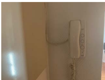
Dørtelefon i entré.
