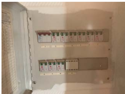
Sikringsskap i entre.
