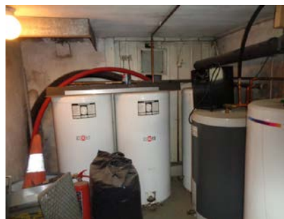
Varmtvannsberedere i kjeller.
