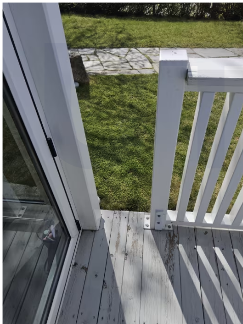
Åpning mellom rekkverk og vinterhage.
