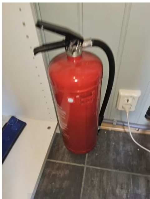
Boligen har godkjent brannslukningsapparat.
