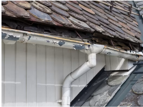
Takrenner bærer preg av alder/slitasje.
