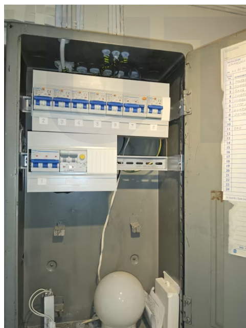
Sikringsskap i gang.
