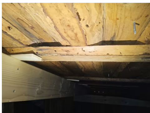
Spor etter borebille i takkonstruksjonen.
