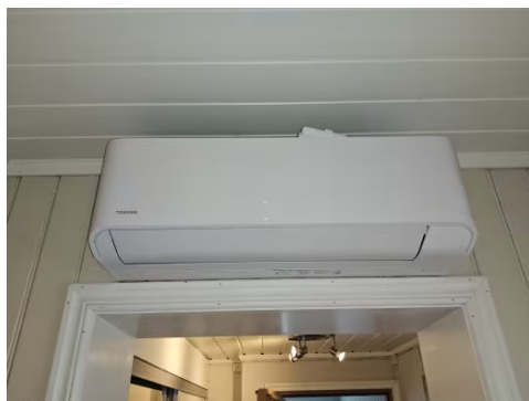
Varmepumpe plassert i gang.
