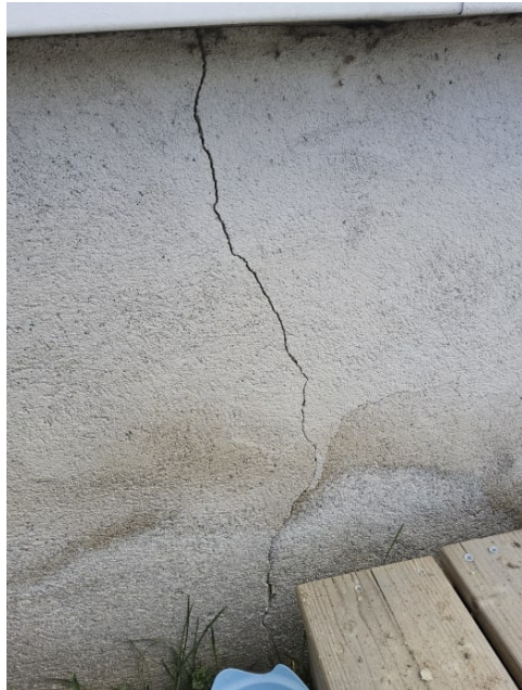
Det registreres enkelte riss/sprekker i grunnmuren.
