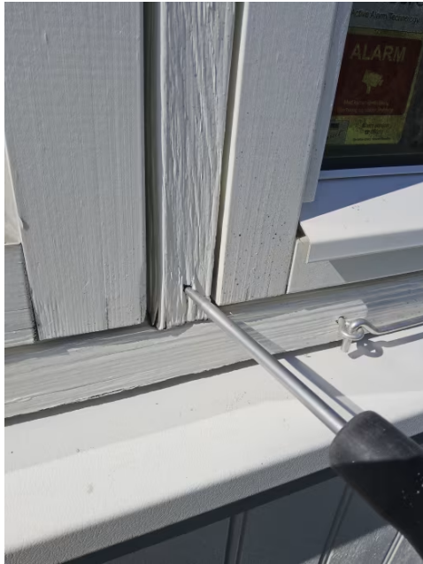
Råteskade i vindu på karnapp.
