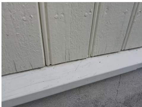
Kledningen er ikke luftet.
