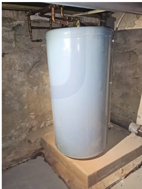
Varmtvannsbereder er plassert i grovkjeller.
