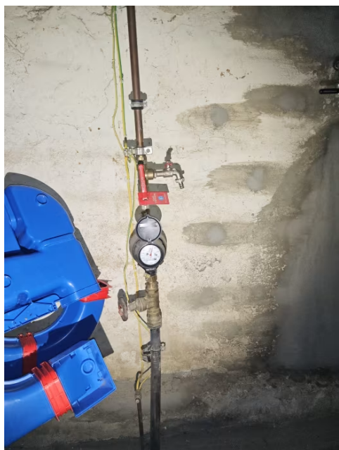
Hovedstoppekran er plassert i kjeller.
