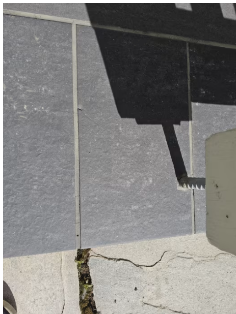
Det er sprekker i enkelte fliser.
