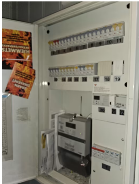
Sikringsskap i entré.
