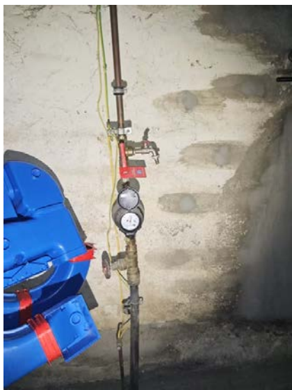
Hovedstoppekran er plassert i kjeller.
