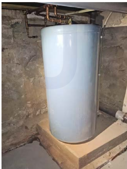
Varmtvannsbereder er plassert i grovkjeller.
