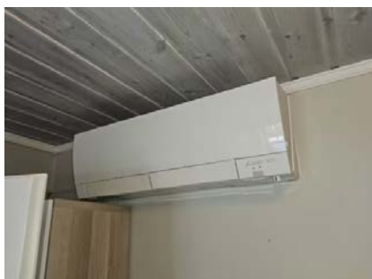
Varmepumpe plassert i stue.
