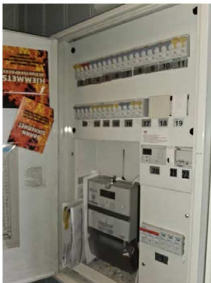
Sikringsskap i entré.
