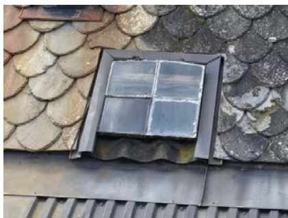
Takvindu bærer preg av høy slitasje.
