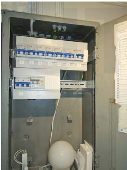
Sikringsskap i gang.
