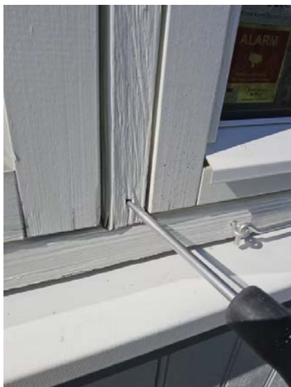
Råteskade i vindu på karnapp.
