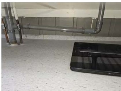
Avløpsrør med motfall under servantinnredning på bad i første etasje.
