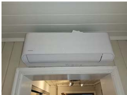
Varmepumpe plassert i gang.
