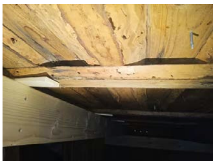
Spor etter borebille i takkonstruksjonen.
