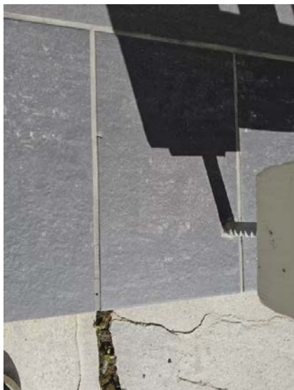
Det er sprekker i enkelte fliser.
