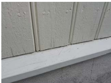
Kledningen er ikke luftet.
