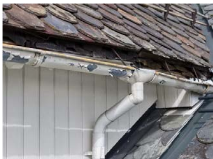
Takrenner bærer preg av alder/slitasje.
