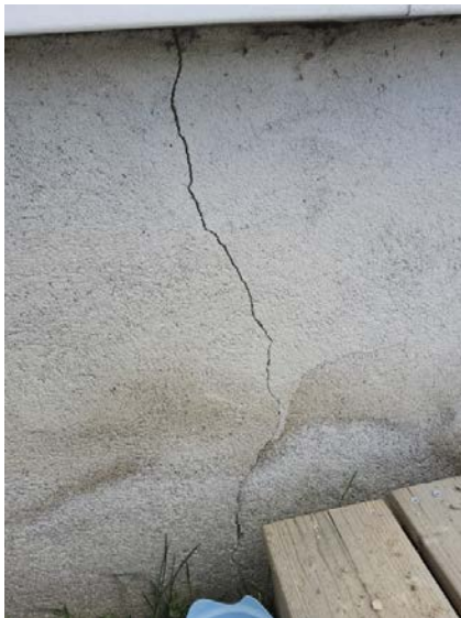
Det registreres enkelte riss/sprekker i grunnmuren.
