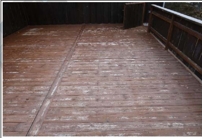
Eksempel på overflateslitasje på terrassegulv mot sørvest.
