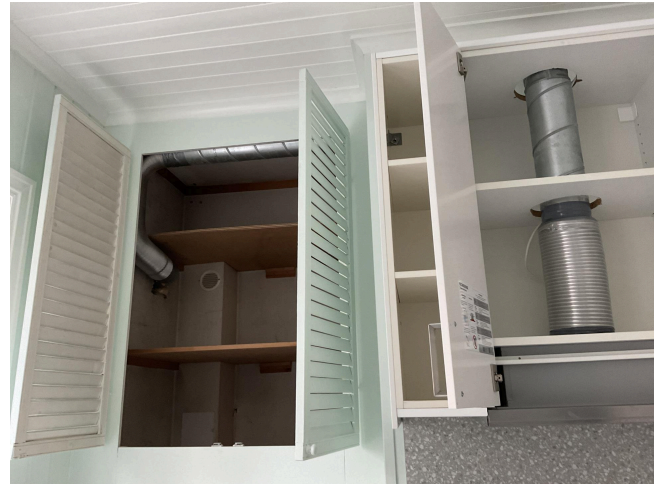
Avtrekk med kanal fra ventilator og til yttervegg.
