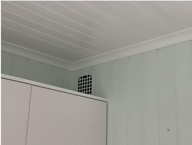
Avtreksventil til luftpipe.
