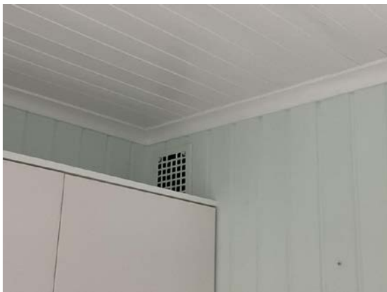
Avtreksventil til luftepipe.
