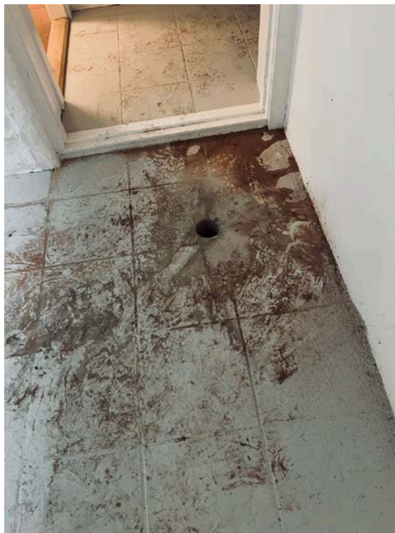
Det er kjerneboret hull i gulv.
