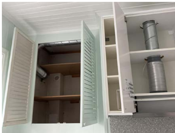
Avtrekk med kanal fra ventilator og til yttervegg.
