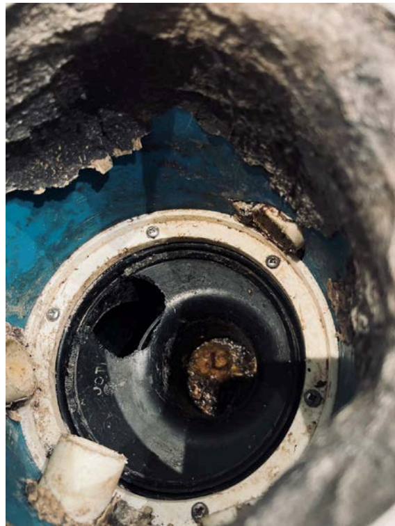
Sluk med skade.
