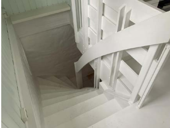
Store åpninger i rekkverk. Manglende håndløper på vegg.
