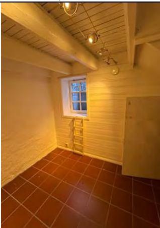
3.3 Vindu, soverom 2. Her er det fastmontert trinn opp til vindu.
