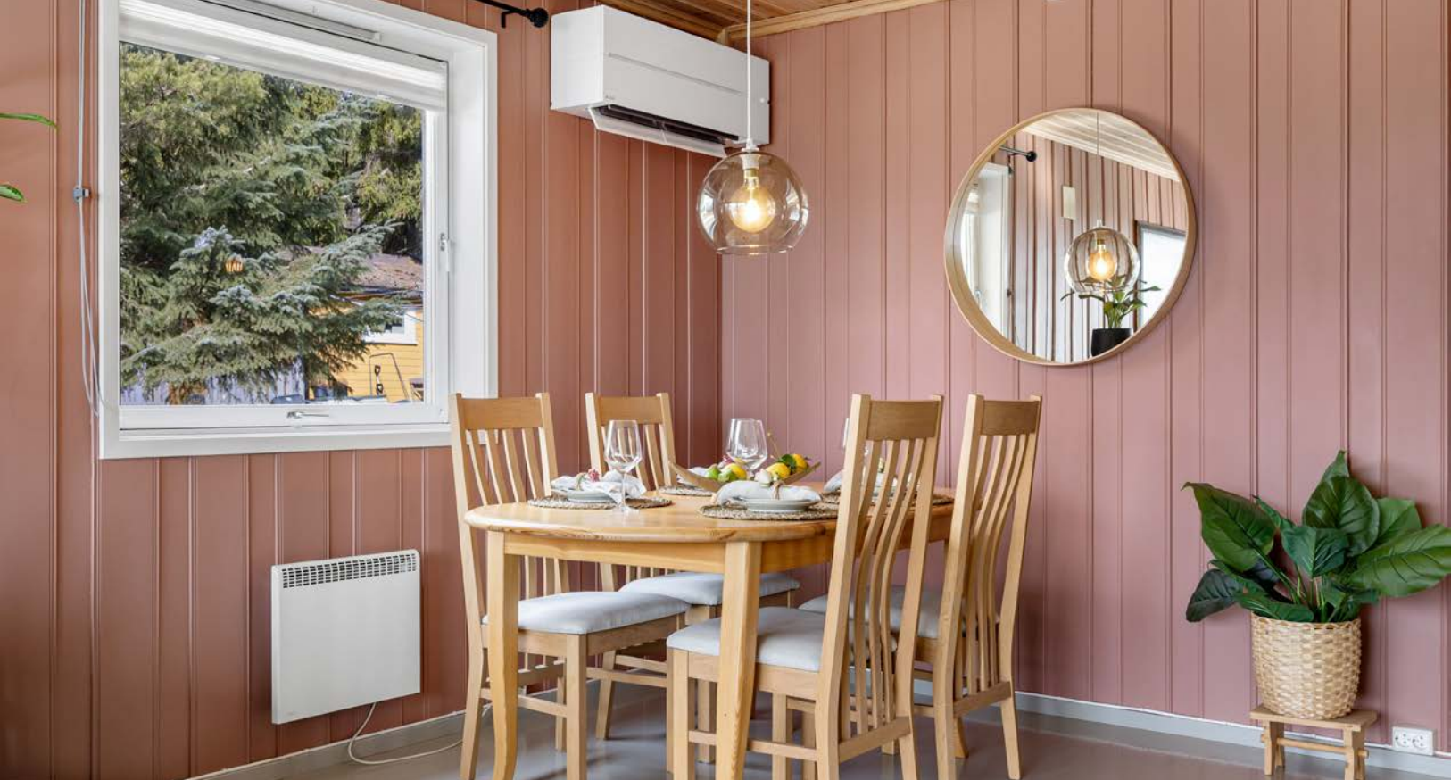
Ved spisestuen er det monteret luft-til-luft varmepumpe fra 2023 som sørger for en god og jevn varme på vinterstid.
