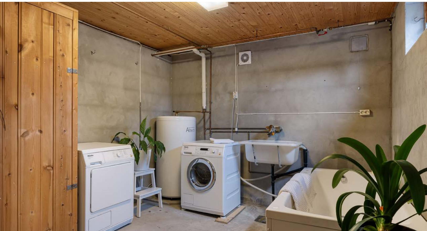
Vaskerommet i kjelleren er utstyrt med utslagskum, badekar, varmtvannsbereder fra 2011 og opplegg for vaskemaskin.
