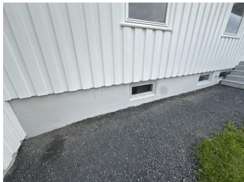
Det registreres manglende bruk av grunnmursplast.
