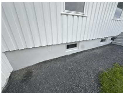
Det registreres manglende bruk av grunnmursplast.
