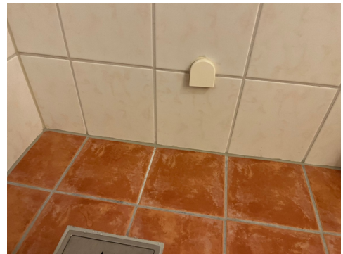
Gjennomføring i dusjsone.
