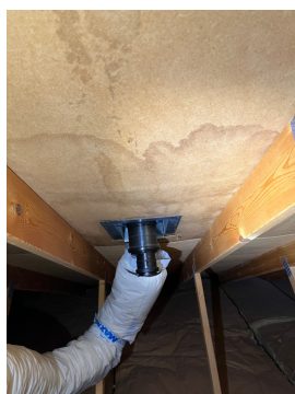
Tydelige fuktskjolder på undertak.
