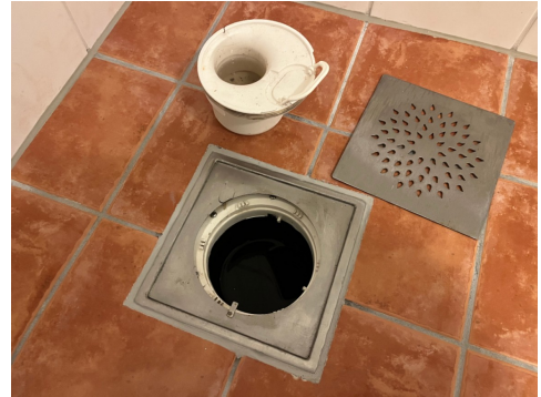
Sluk i dusjsone.
