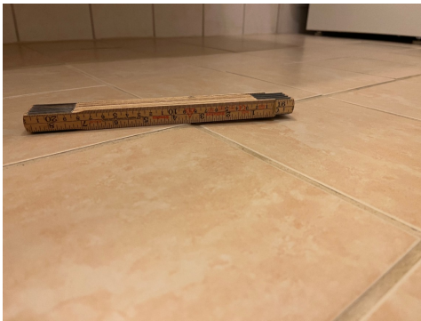
Sprang på enkelte gulvfliser.
