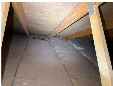
Isolasjon ligger inntil undertak.
