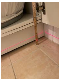
Måling med laser viste noe motfall på gulv ved berederskap.
