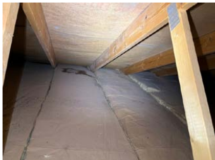
Isolasjon ligger inntil undertak.
