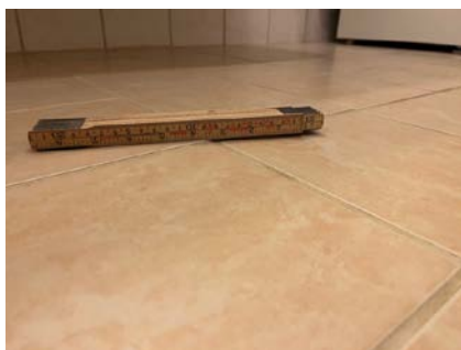
Sprang på enkelte gulvfliser.
