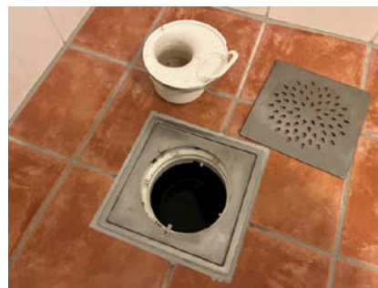
Sluk i dusjsone.
