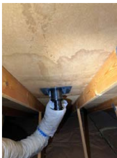
Tydelige fuktskjolder på undertak.
