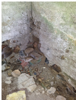
Mur i rom under terreng forvitrer ned mot betonggulv
