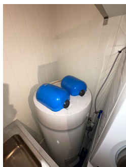
Ekspansjonskar er montert på toppen av tanken
