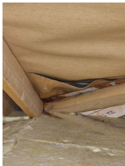
Ingen fukt er påvist ved kontroll av gradrenne, det er synlig avvik
