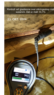
Kontroll ved gradrenne over sikringsskap mot soverom på kryploft. Det er målt 14,1% hvor det er merket etter tidligere fukttskade. Ingen forhøyde fuktavvik
