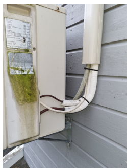
Mangelfull isolering av rør mot ytterdel
