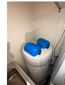
Ekspansjonskar er montert på toppen av tanken
