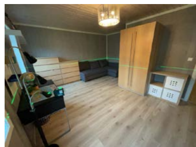
2. etasje Plassering av laser ved kontroll av soverom 3/stue. Det er målt 11 mm høydeforskjell gjennom rommet. TG 1
