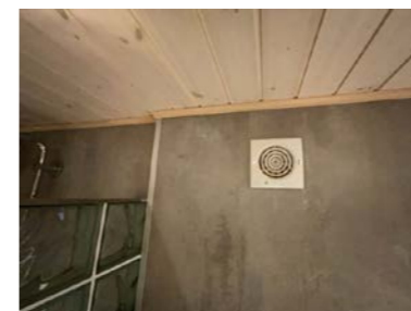
Mekanisk avtrekk på vegg
