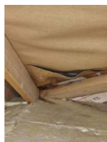
Ingen fukt er påvist ved kontroll av gradrenne, det er synlig avvik
