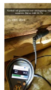
Kontroll ved gradrenne over sikringsskap mot soverom på kryploft. Det er målt 14,1% hvor det er merket etter tidligere fuktskade. Ingen forhøyde fuktavvik
