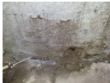
Mur i rom under terreng forvitrer ned mot betonggulv
