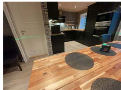
1. etasje Plassering av laser ved kontroll av kjøkken. Det er målt 11 mm høydeforskjell gjennom rommet. TG 1
