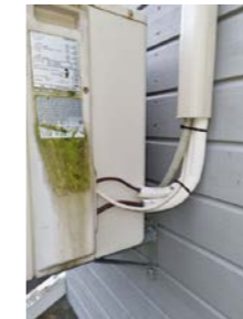
Mangelfull isolering av rør mot ytterdel
