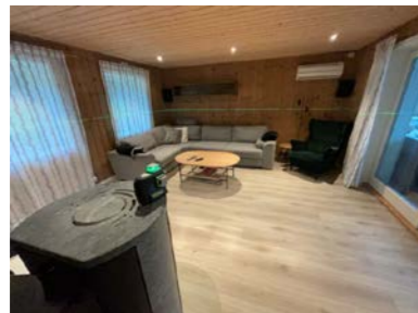
1. etasje Plassering av laser ved kontroll av stue. Det er målt 9 mm høydeforskjell gjennom rommet. TG 1
