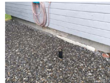
Rør i bakken har utvendig stoppekrane ifølge selger
