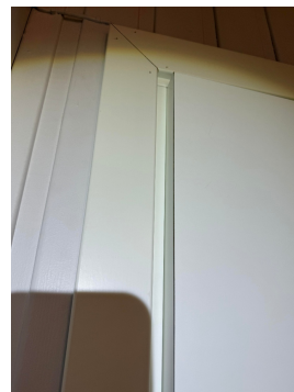
Bilde av ytterdør som tar i karm
