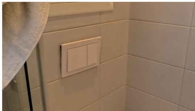
Bilde av spylepanelet til toalettet.
