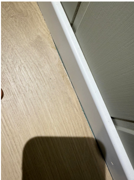
Bilde av glippe mellom laminatgulv og gulvlist
