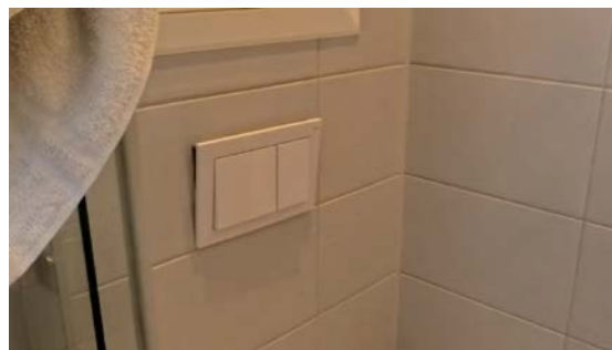
Bilde av spylepanelet til toalettet.
