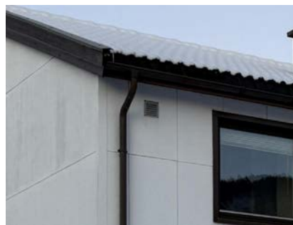
Bilde av ventil fra avtrekksvifte på yttervegg
