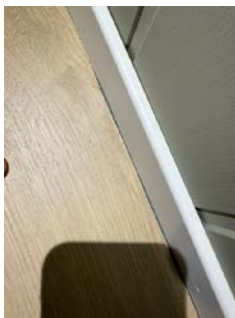
Bilde av glippe mellom laminatgulv og gulvlist
