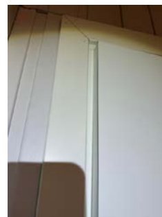
Bilde av ytterdør som tar i karm
