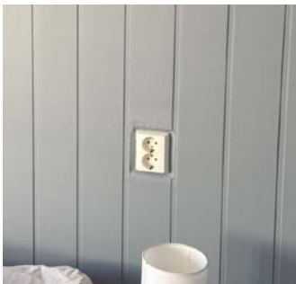
Bilde av veggplate med utskjæring for kontakt
