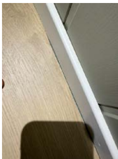
Bilde av glippe mellom laminatgulv og gulvlist
