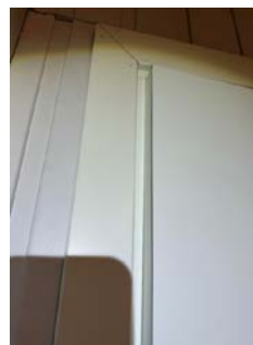
Bilde av ytterdør som tar i karm
