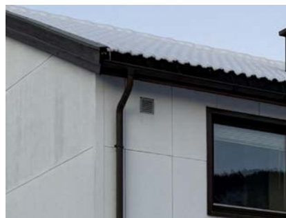
Bilde av ventil fra avtrekksvifte på yttervegg
