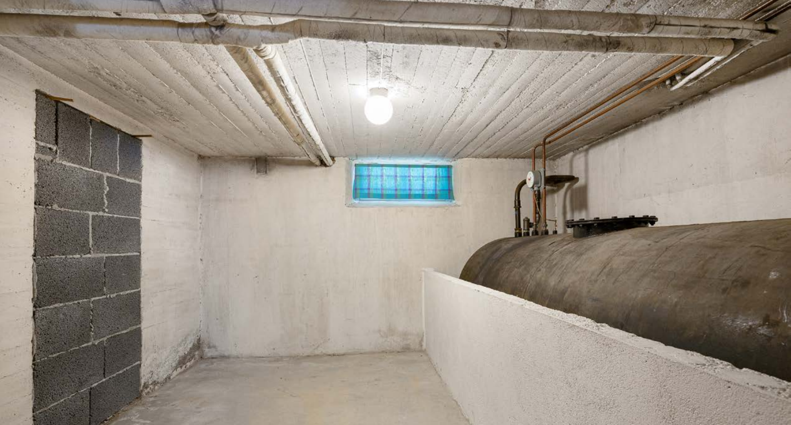
I det ene kjellerrommet er det en oljetank i stål. Oljefyren har elektrisk kolbe, og anlegget forsyner boligen med varmt tappevann og vannbåren varme til enkelte radiatorer.
