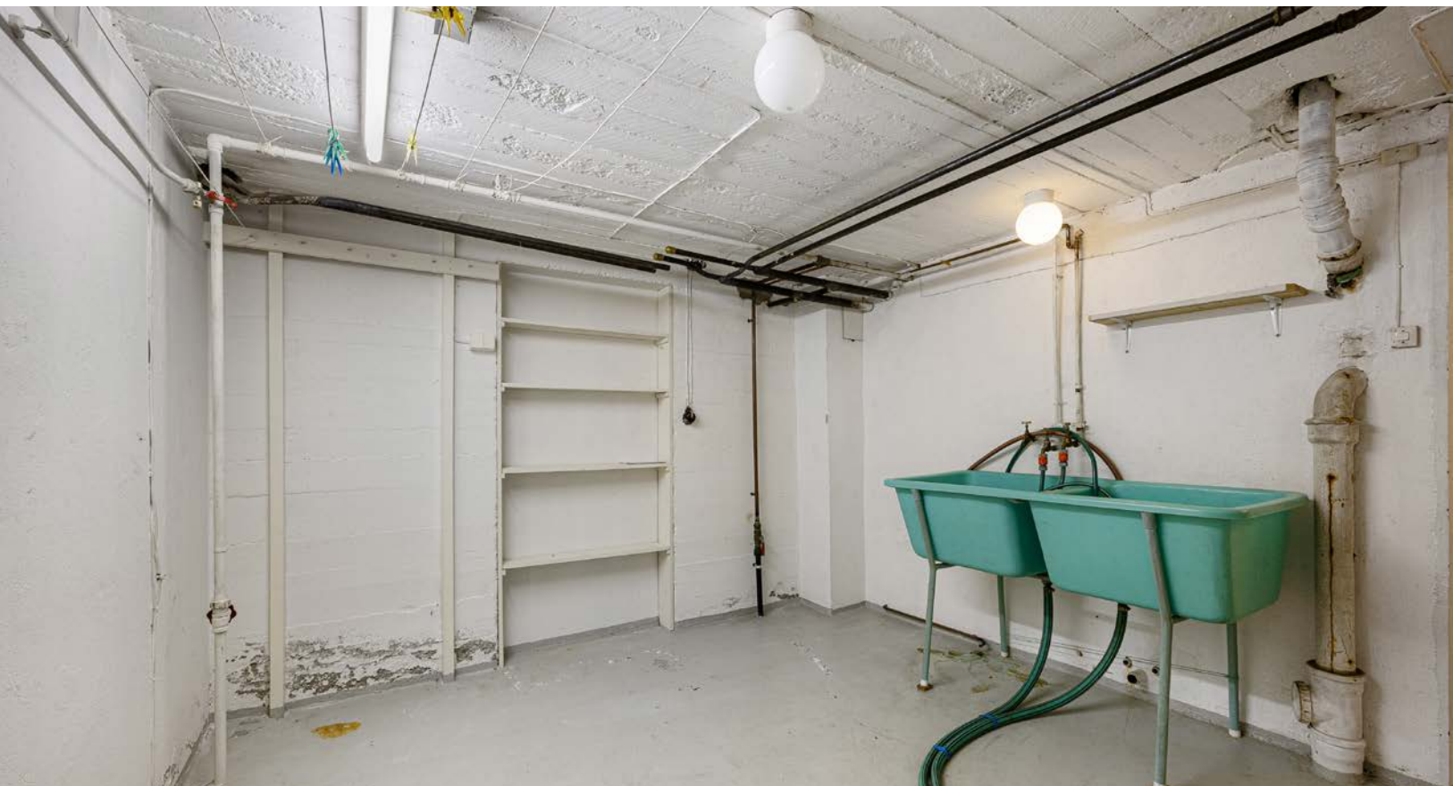
Vaskerommet har to utslagsvasker av plast.
