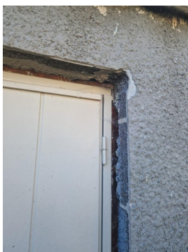
Dør mangler innpussing/anslag.
