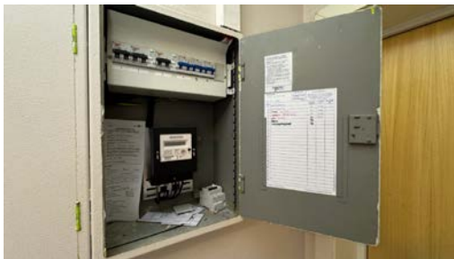
Kontroll av el-skap og kursfortegnelse.
