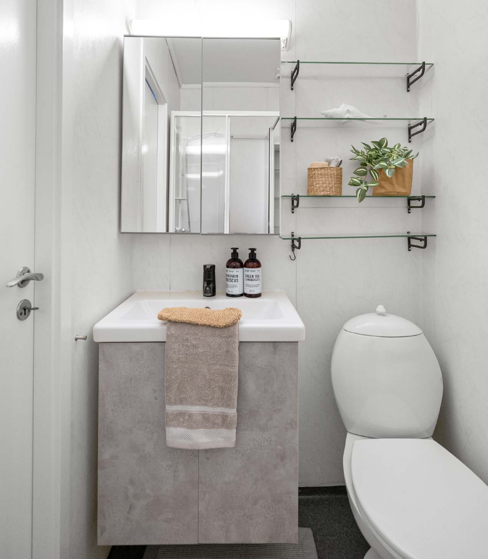
Badet er innredet med toalett, vask i servantskap og dusjkabinett.
