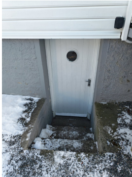
Fare for fall / manglende rekkverk
