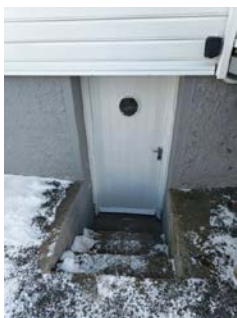
Fare for fall / manglende rekkverk
