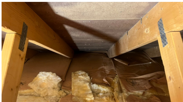
Manglende ventilering av takkonstruksjonen ved takfoten.
