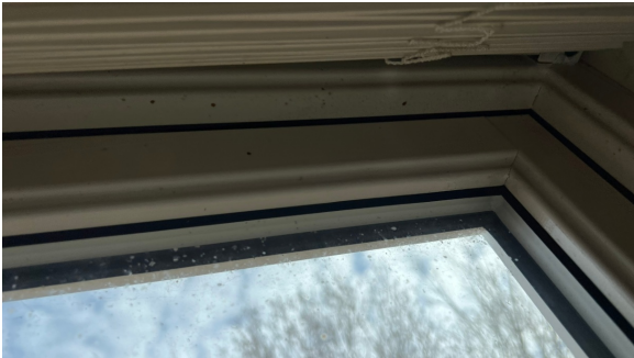
Både veggen og vinduet mangler ventil
