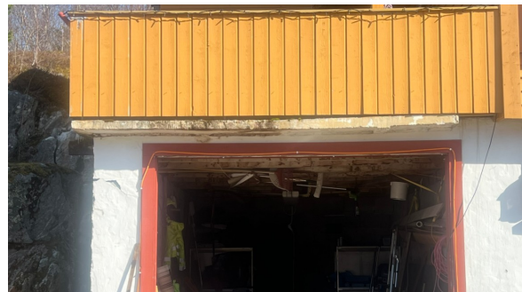
Kraftige skader i betongdekket
