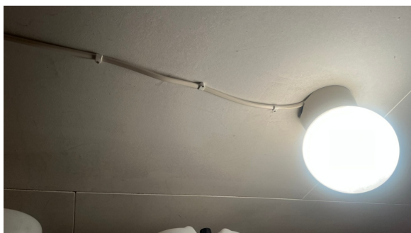
Lyspunkt med skade og ufagmessig installasjon
