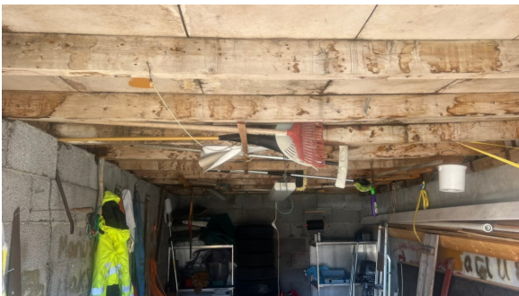
Etasjeskillet fra undersiden har skader
