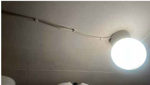
Lyspunkt med skade og ufagmessig installasjon
