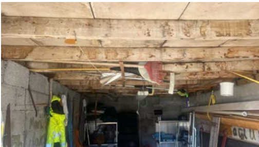
Etasjeskillet fra undersiden har skader
