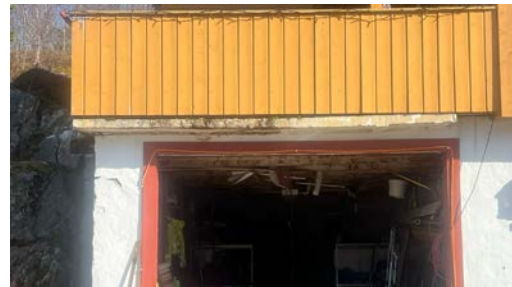
Kraftige skader i betongdekket
