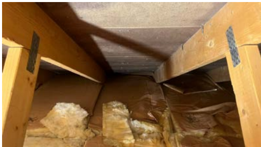
Manglende ventilering av takkonstruksjonen ved takfoten.
